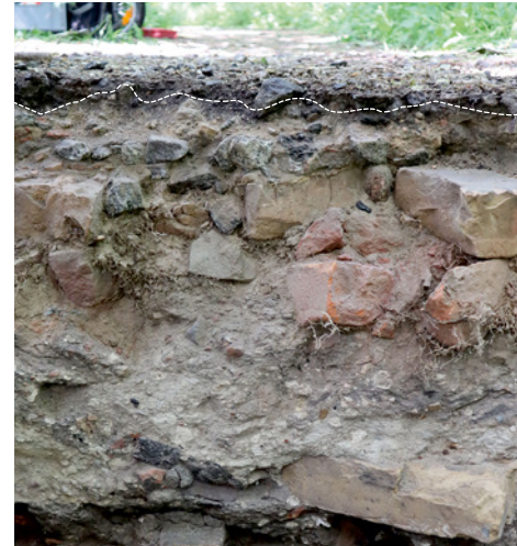
Trümmerschutt im Untergrund eines entsiegelten Forstweges im Grunewald
