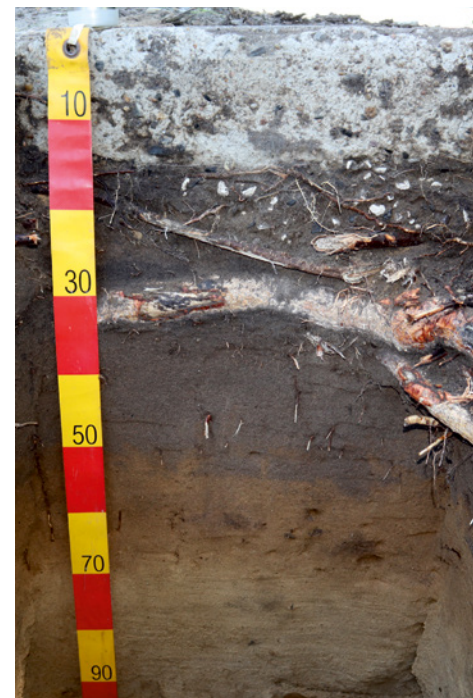
Intensive Durchwurzelung unterhalb der Versiegelung
